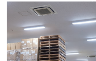
品質と快適な環境を守る空調設備
