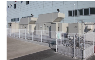
電力を安定供給する非常用発電機
